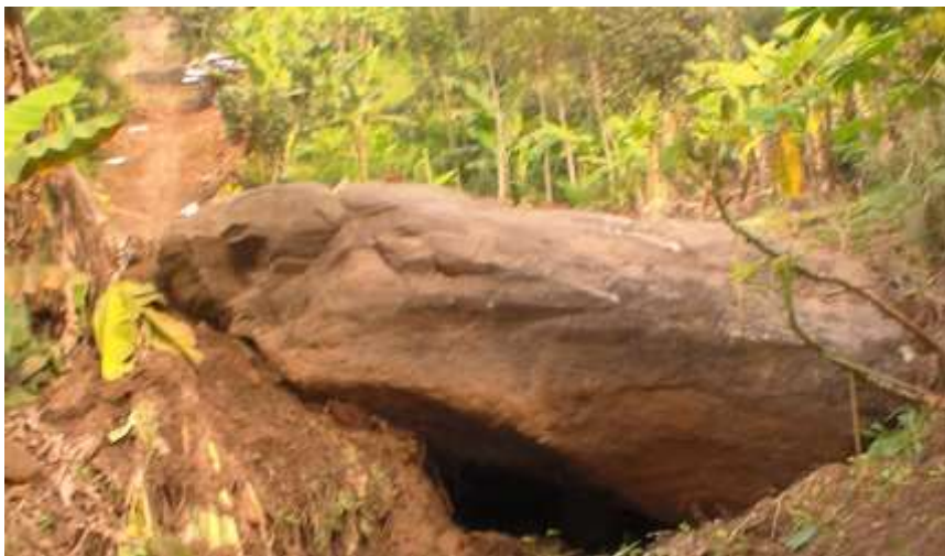
Figure 10 : Bloc écroulé de la paroi rocheuse située en amont.
