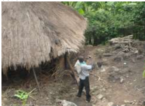
Figure 11 : Destruction d'une cuisine par un écoulement torrentiel permanent, gonflé par la pluie.
